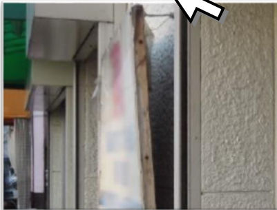
壁面取付け部の異常
