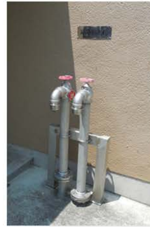
写真：応急給水栓
