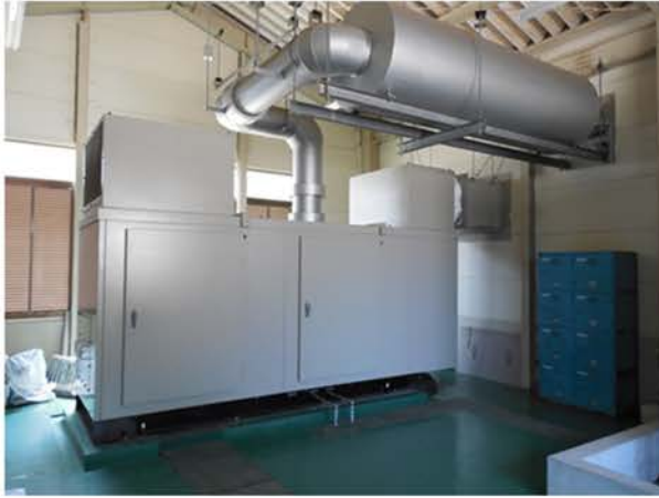
写真：自家発電設備
