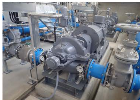
写真：更新後のポンプ設備
