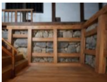
補強架構（松江市 HP より）
