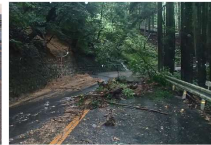
(例) 法面崩落、倒木
